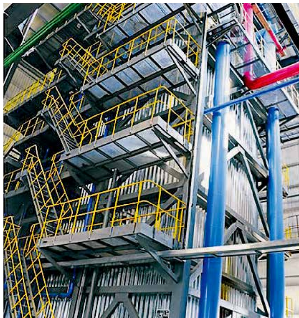
公司项目 - 蒙阴县供热处 60 吨煤粉锅炉
